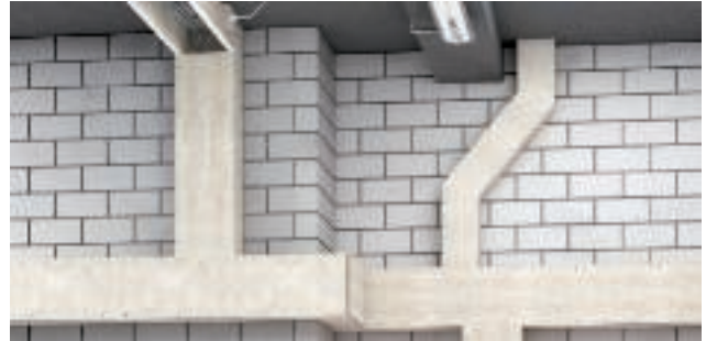
Gemonteerd brandwerend kanaal aan de wand en plafond
