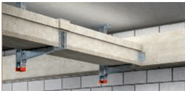
Combinatie afgehangen brandwerend kanaal met wandkanaal
